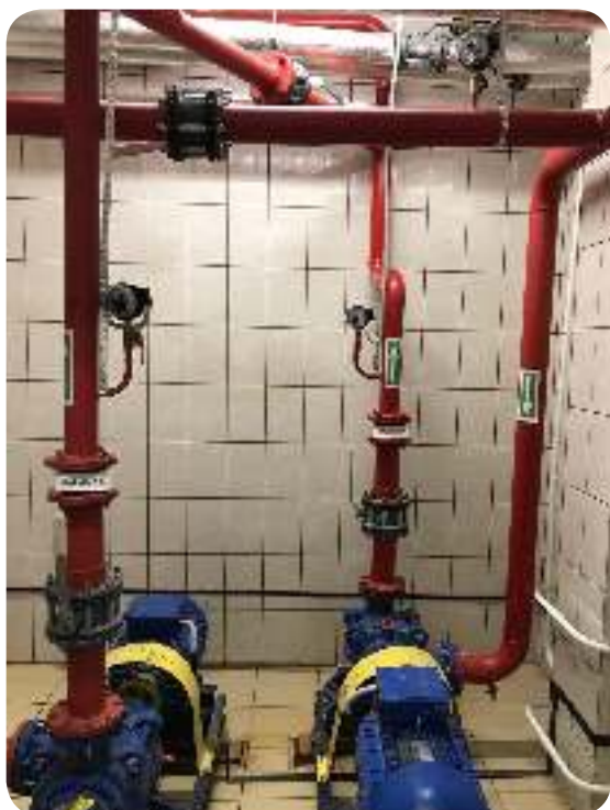
ИНДИВИДУАЛЬНЫЙ ТЕПЛОВОЙ ПУНКТ
