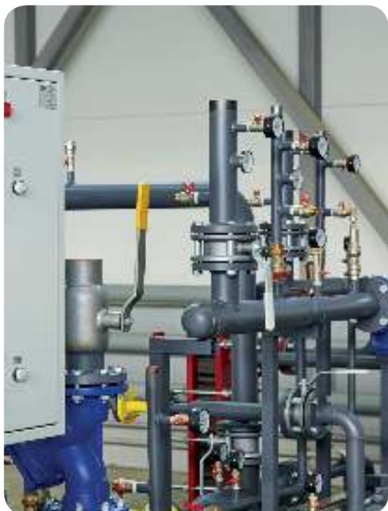
ИНДИВИДУАЛЬНЫЙ ТЕПЛОВОЙ ПУНКТ
