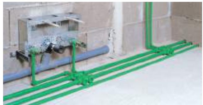
Распределительный блок для водоснабжения
