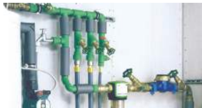
Точка ввода в здание
