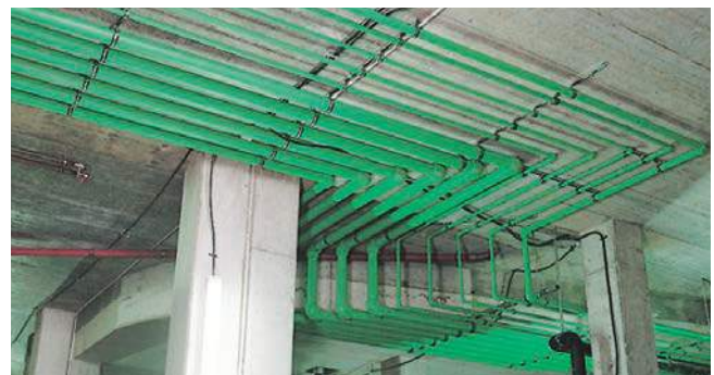
Трубопроводные линии для этажей
